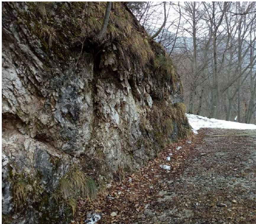
Fig. 16: La parte alta della parete necessita di uno scoronamento da eseguire con benna o martellone.
