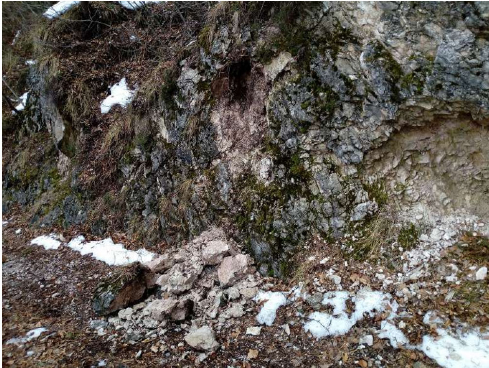
Fig. 15: La roccia calcarea si sfalda molto facilmente.
