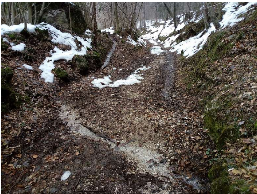
Fig. 4: canaletta in legno completamente da sostituire presso la sezione di progetto n. 2.
